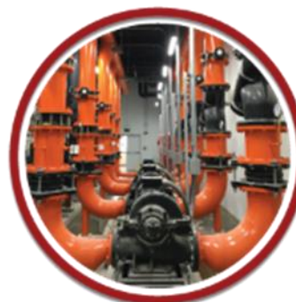
FIRE PROTECTION & IRRIGATION SYSTEM งานระบบดับเพลิงและชลประทาน
